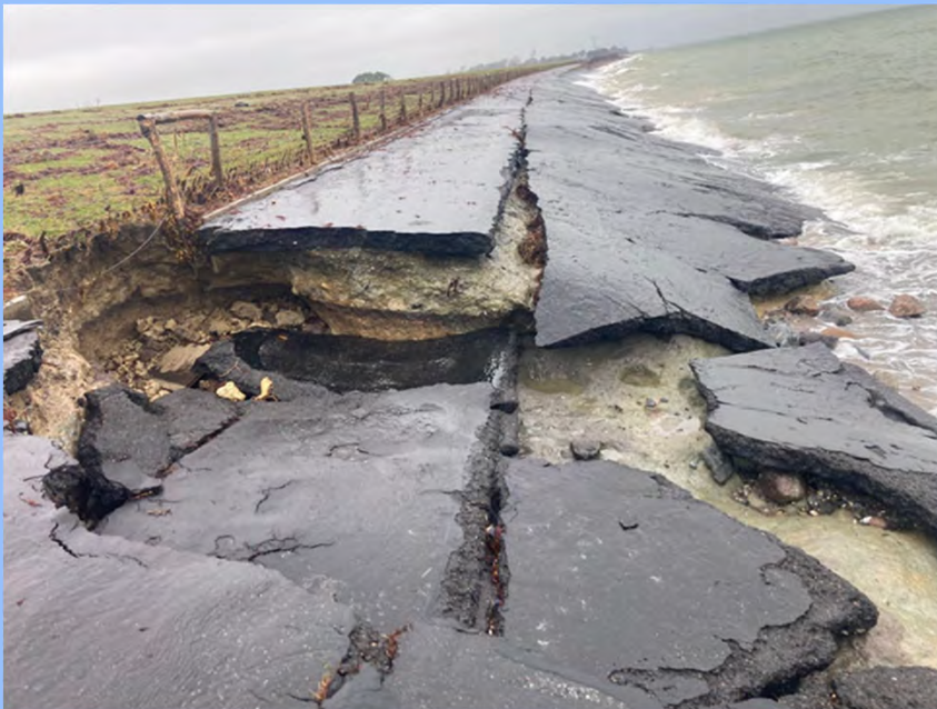
Schäden am Asphaltdeckwerk Presen (21.10.23)
