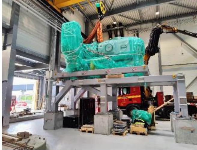
MAN Kompressor auf der Baustelle
