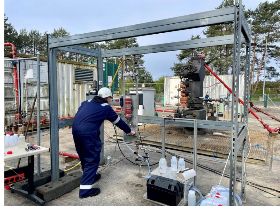
Prototyp einer Lithium Extraktionsanlage Hergestellt von Hydrosion und EnBW
