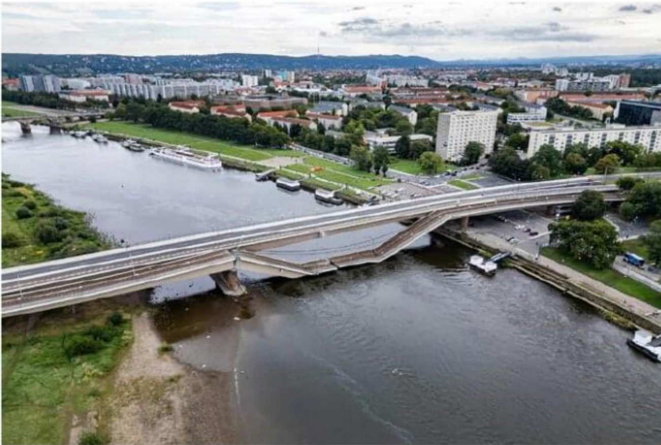
Die Carolabrücke von oben: Hätte der Kollaps von Brückenzug C verhindert werden können? © picture alliance/dpa
